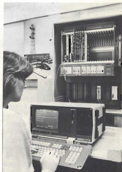
Automatismo di stazione Sinaut ST 1: si tratta di un sistema programmabile della Siemens per automatizzare pipeline e reti di distribuzione. Tramite i processori di comunicazione vi si possono collegare anche stampanti e sistemi sovraordinati.
